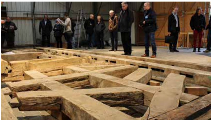
Ausgelegtes Fachwerk zur Durchsicht und Reparatur vor dem Richten (Aufbau der Dach- und Fachwerkkonstruktion), 2017, Foto: Freilichtmuseum Hessenpark
